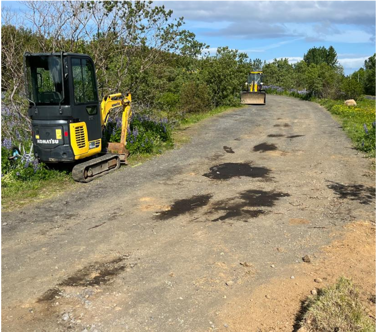
Olíublettir eftir vinnuvélar á Vatnsveituvegi við Vatnsveitubrú. Mynd: Árni Guðmundsson.
